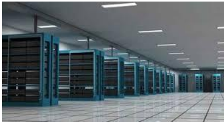
Figura 4 – Sala de servidores
